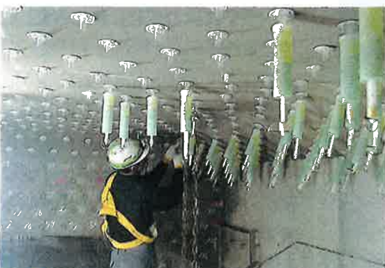
写真4 ■ 高架橋の床版下面の補修工事にIPH工法を採用した例(写真:IPH工法協会)
