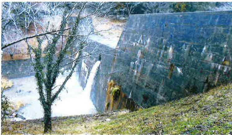
写真1 ■ 補修前の仁王川砂防堰堤。1975年に完成した。堤体のひび割れから草などが生えていた(写真:右ページも中日建設)
